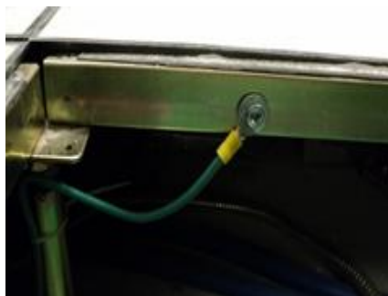
Aterramento do Piso Elevado
