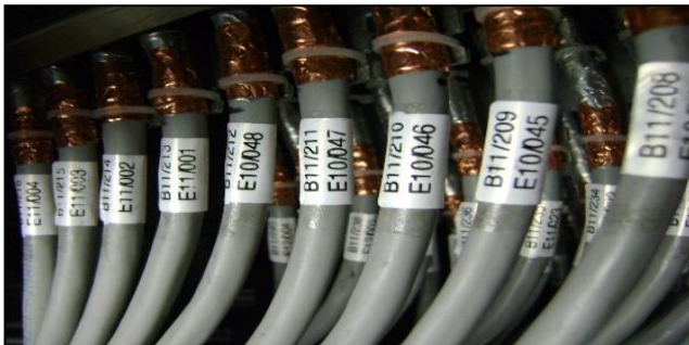
Permanent links identificados na parte traseira do cabo (patch panel)
