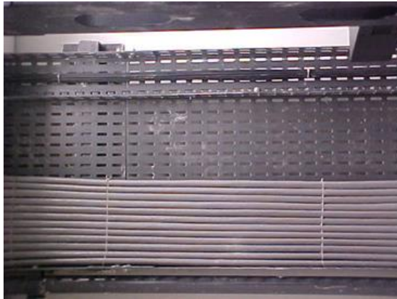
Separação física entre cabos UTP e cabos de energia
