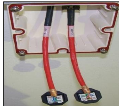
Permanent links identificados no cabo (Área de Trabalho)
