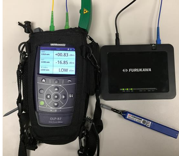
Medição de potência na entrada da ONT
