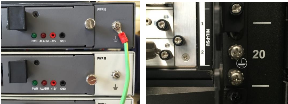
Indicação dos pontos de aterramento dos equipamentos Furukawa
