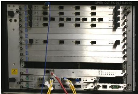
Fechamento INCORRETO do chassi
