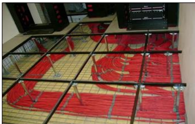
Acomodação dos cabos sob o piso elevado
