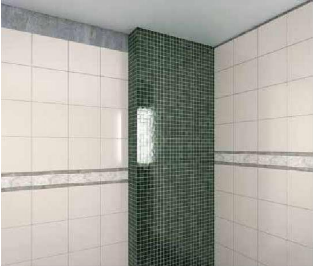
Exemplo de um ambiente em que a colocação dos azulejos não foi planejada (paginação), ocorrendo o desencontro das alturas das faixas decorativas e das juntas horizontais. Além disso, os azulejos no encontro do teto ficaram com tamanho diferente.
