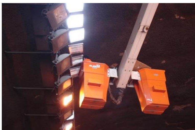
Figura 5.6 – Aplicação da tecnologia LED em trecho do RodoAnel
