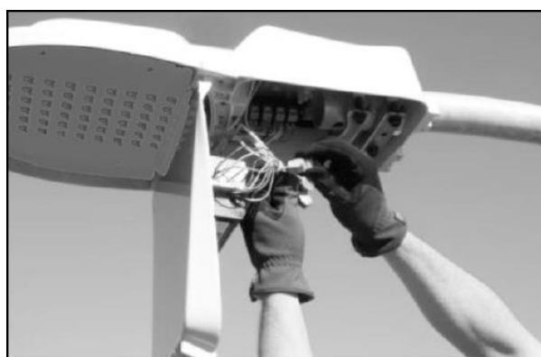
Figura 4.17 – Luminária LED com o anteparo pendente em segurança
