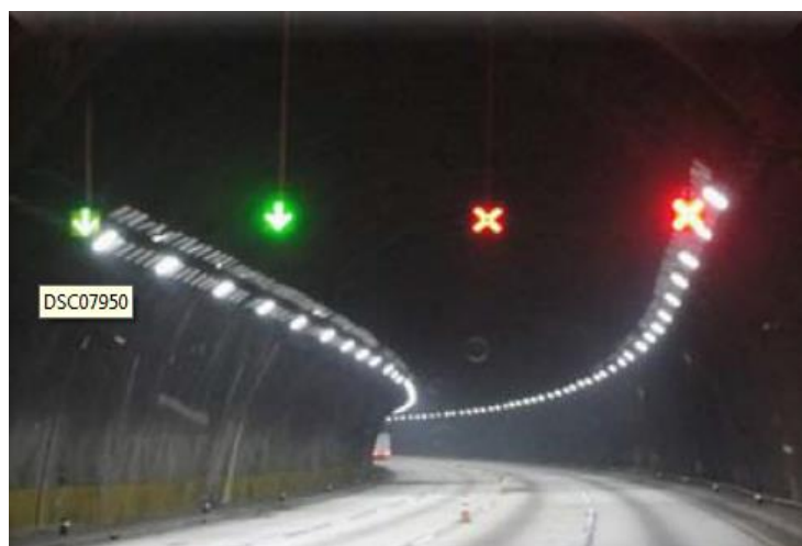
Figura 5.5 – Trecho de túnel do Rodoanel após a instalação do sistema LED (Fonte: CCR)
