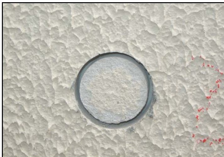
Figura 58 - Forma de ruptura na camada da pintura
