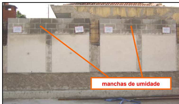
Figura 41 - Manchas de umidade no substrato e no painel teste
