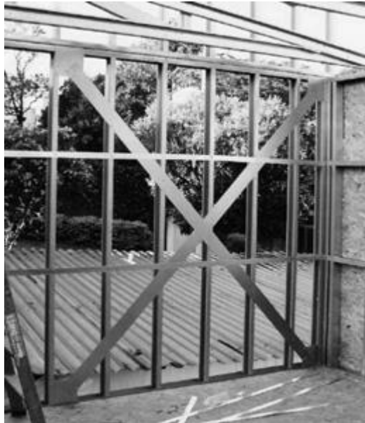
Foto 2 - Painel com contraventamento em "X"
