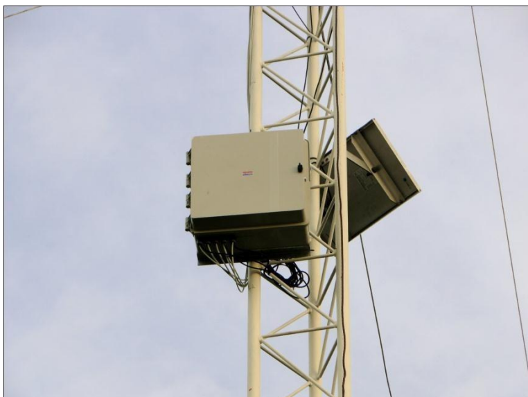
Figura 57. Caixa e Painel solar.
