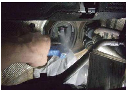
Fazer a limpeza com nitrogênio comprimido
